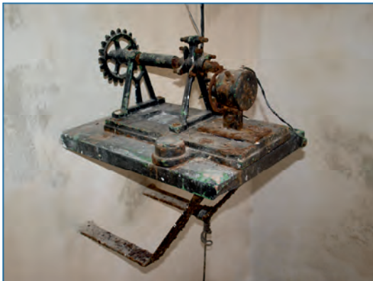
Vízállásmérő a víztároló medencénél (üzemen kívül)
